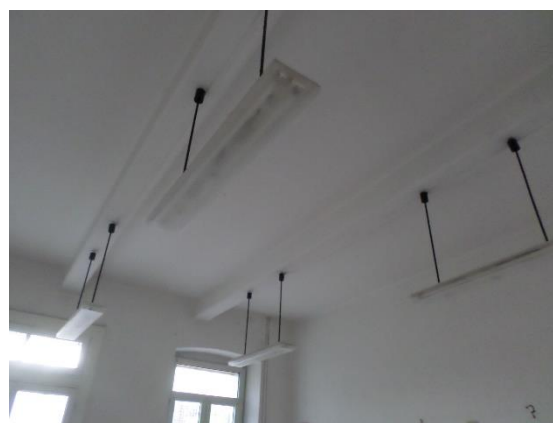
Figura 8.6 - Particolare dei corpi illuminanti attualmente installati
