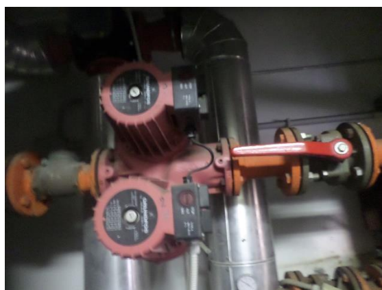
Figura 8.4 - Particolare delle pompe di circolazione
