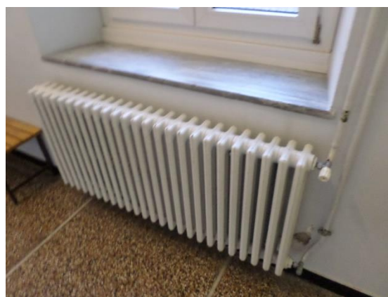
Figura 8.5 - Particolare dei terminali di emissione installati
