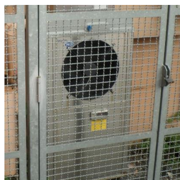
Figura 4.18 - Particolare unità motocondensante
