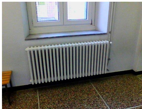
Figura 4.7 - Particolare dei radiatori installati a parete
