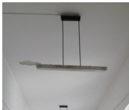
Figura 4.19 - Particolare dei corpi illuminanti ubicati nei corridoi
