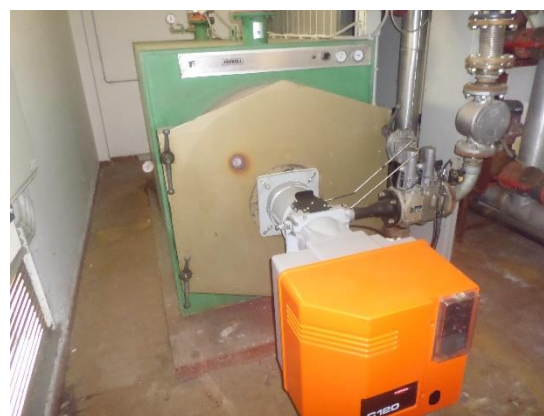
Figura 8.3 - Particolare del generatore di calore attualmente installato
