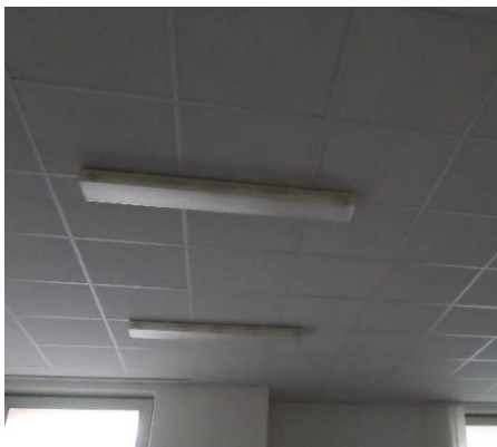
Figura 4.21 - Particolare dei corpi illuminanti a soffitto
