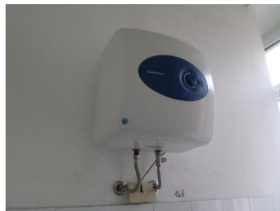
Figura 4.17 - Particolare di un boiler elettrico per la produzione di acqua calda sanitaria
