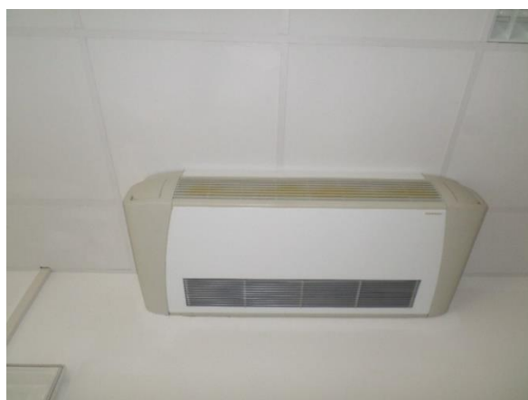
Figura 4.6 – Particolare dei fancoil a soffitto installati nell'asilo nido.
